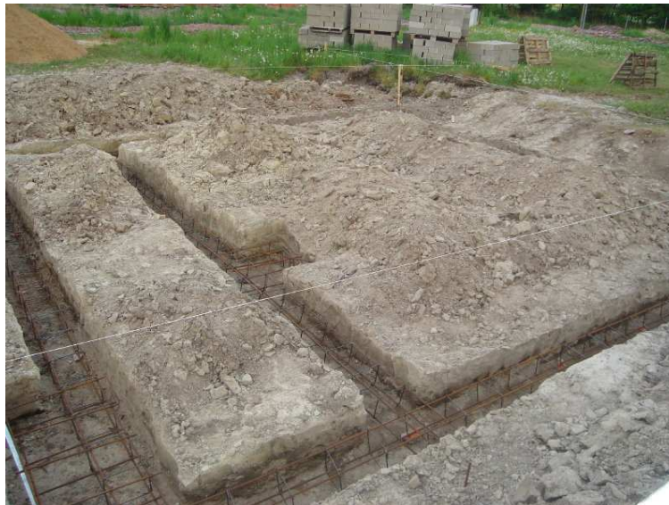
Uziom fundamentowy stanowi bednarka ocynkowana o minimalnych wymiarach 25x4mm przyspawana do zbrojenia ław fundamentowych. Należy pamiętać o przyspawaniu jej do drutów zbrojeniowych, gdyż zapewni to dobry kontakt elektryczny.
